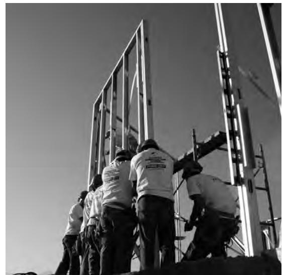
Anclaje de bastidores de planta baja a losa de cimentación con herramienta de percusión accionada por disparo de salva cal. 22.
